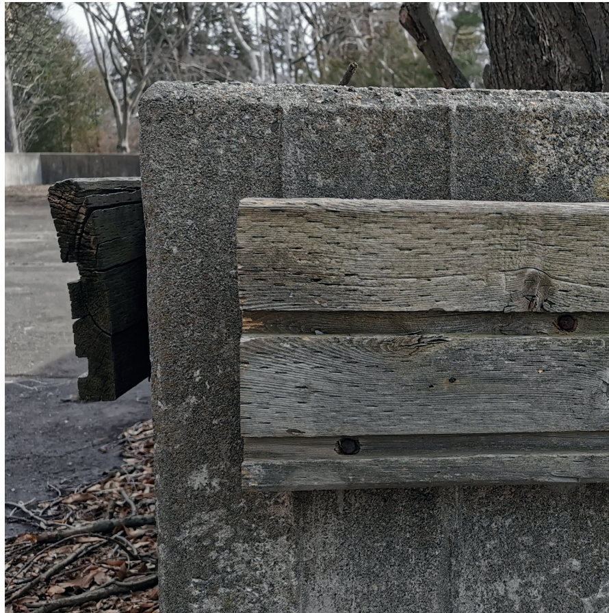
Détail de la main courante existante
