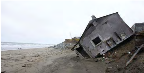
De nombreuses habitations sont affectées par le réchauffement du pergélisol | source: http://www.lemonde.fr/planete/portfolio/2007/02/02/les-consequences-deja-visibles-du-rechauffement_860890_3244.html
